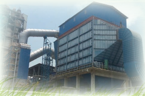
华润水泥(平南)有限公司3#窑头袋式除尘器
